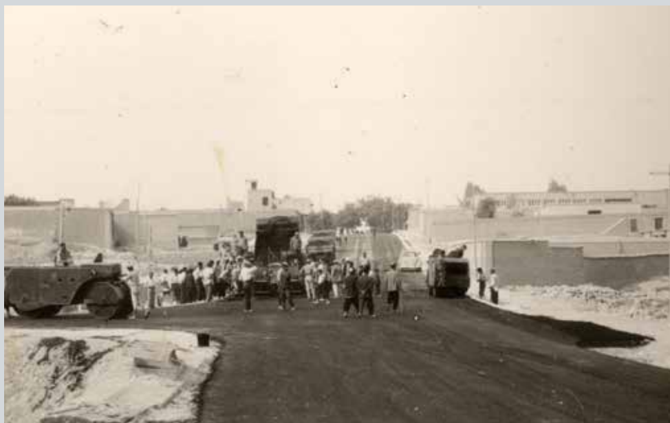
Vejen asfalteres med tæppebælægning i juni 1960. Temperaturen var den dag 49°C og asfalten over 100°C, så „man svedte lettere“, som Milner udtrykte det.
