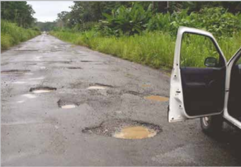
En asfalteret vej i dårlig stand får meget hurtigt store huller. Især i regntiden vokser små revner hurtigt til store huller. Foto Jørgen Burchardt 2013.
