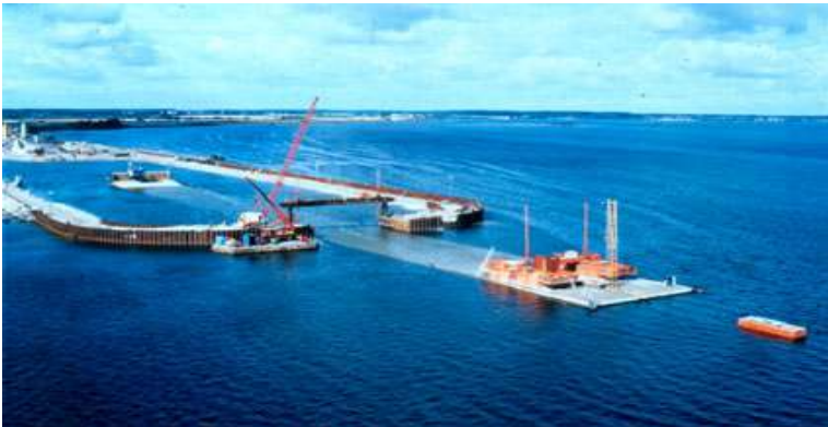
Pihl & Søn var entreprenør på Guldborgsundtunnelen. Et af de 230 m lange tunnelelementer ses her under bugseringen.
